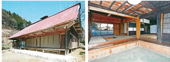
修理前の外観
